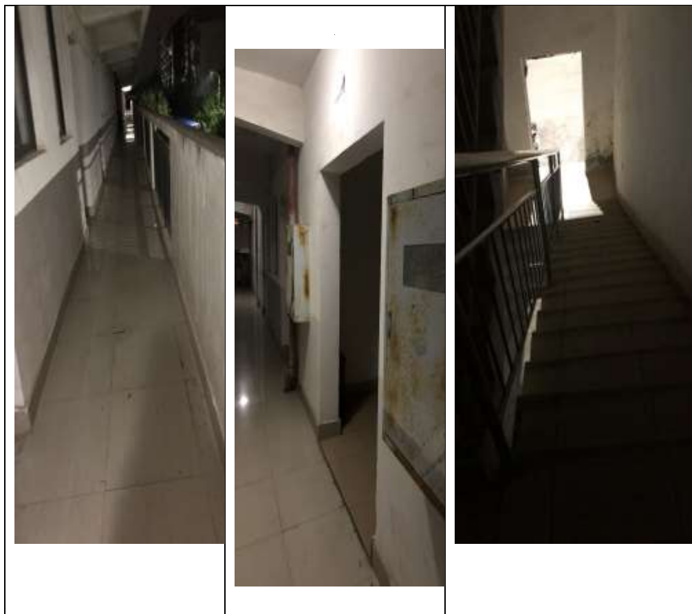
派遣工宿舍无紧急出口和安全通道标志
