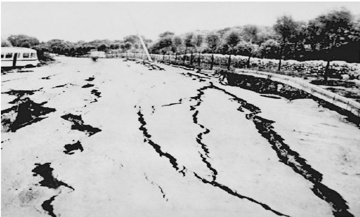
被震裂的公路
