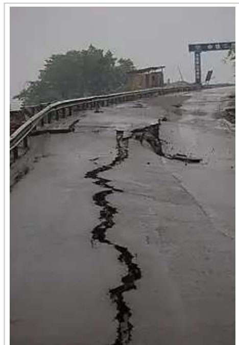
汶川大地震造成的四川省都江堰各地道路嚴重損毀，攝於2008年5月13日
