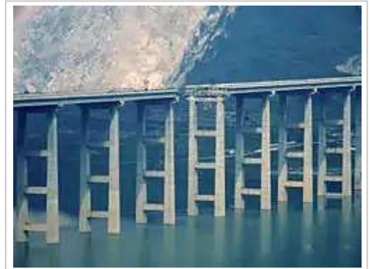
都汶高速公路的庙子坪大桥的桥梁因地震而坠入水库中。
